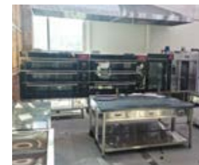
포지티브 스페이스566 데크오븐 설치
